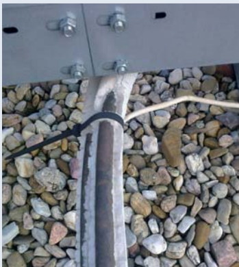
obr. 3 Při použití nekvalitní tepelné izolaci dochází k rozpadu izolace...
